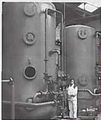
M. Clerissi, du Service Maintenance, à côté de l'installation de filtrage, avant et après transformation.
